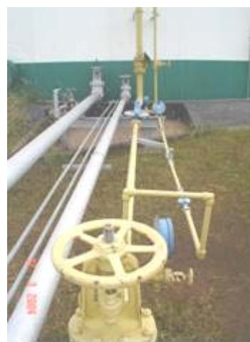
SISTEMA DE INYECCIÓN DE NITRÓGENO
