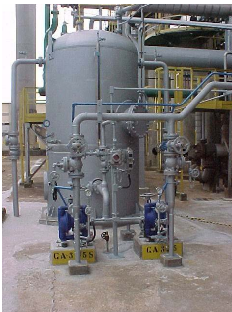
Figura: tanque de almacenamiento del sistema de drenaje cerrado.
